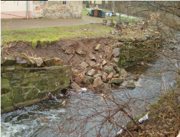
Zustand vorher - Eingestürzte Ufermauer, Absturz
