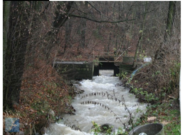
Zustand vorher - nur bei Hochwasser durchgängig
