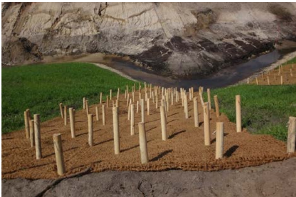
Erosionssicherungen im Bereich einer angetroffenen Störungszone
